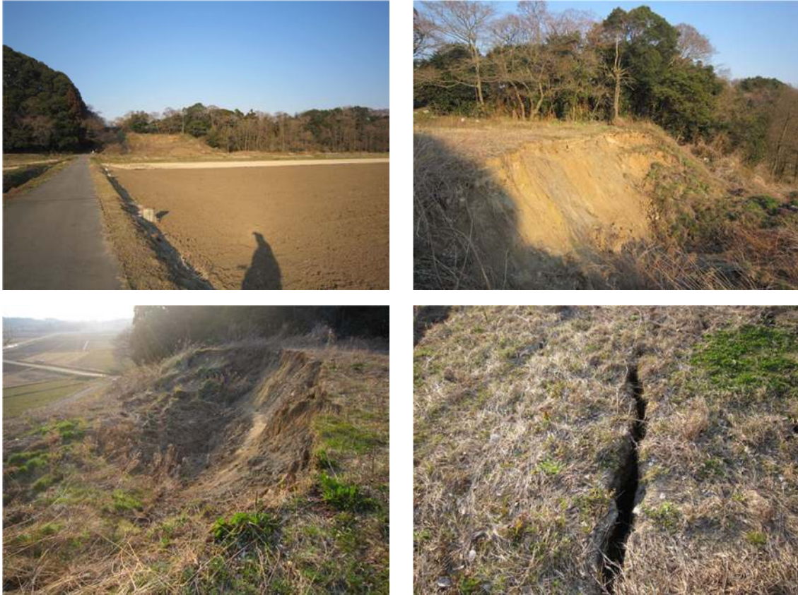
写真3 崖の崩壊状況
