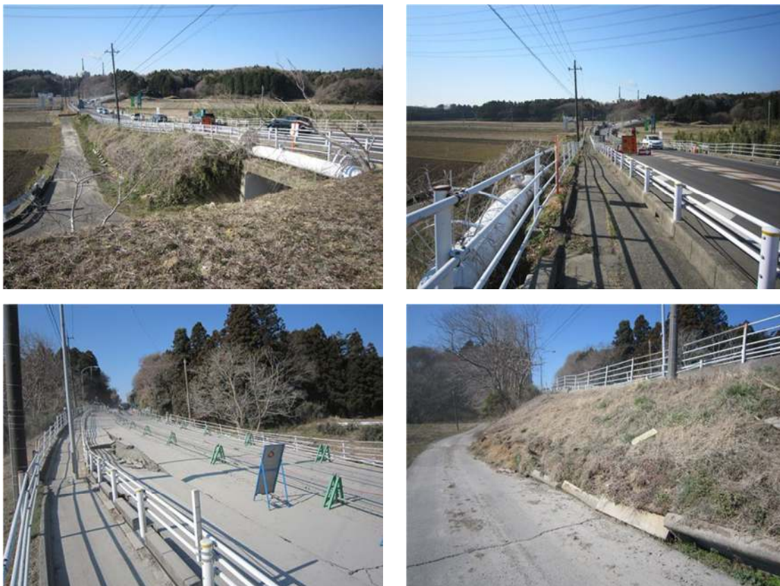
写真 1 県道 284 号盛土の被災状況
