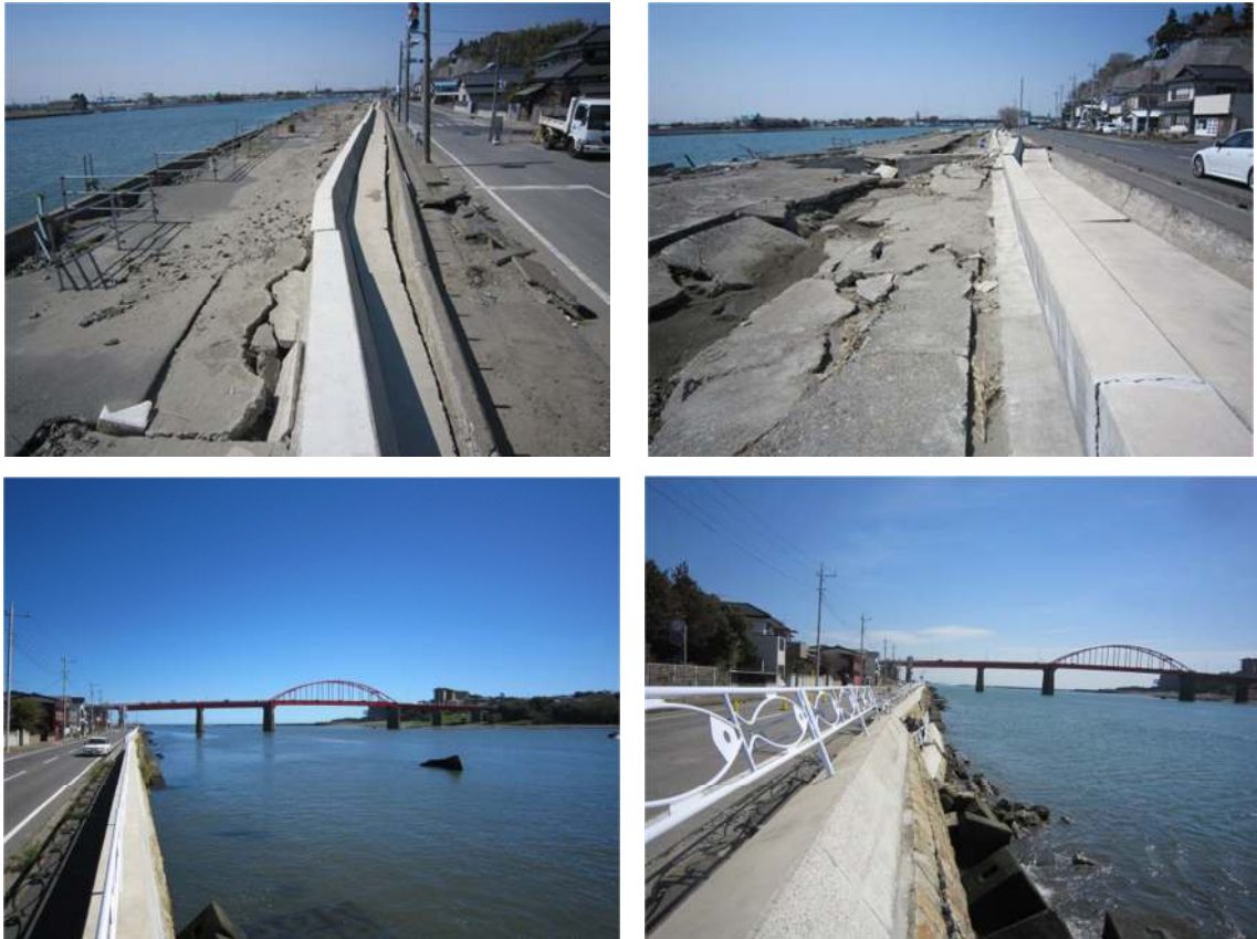
写真 3.2 海門地区の護岸の被災状況 (写真左下は 2010/10/11 撮影 右下は 3/19 日撮影)
