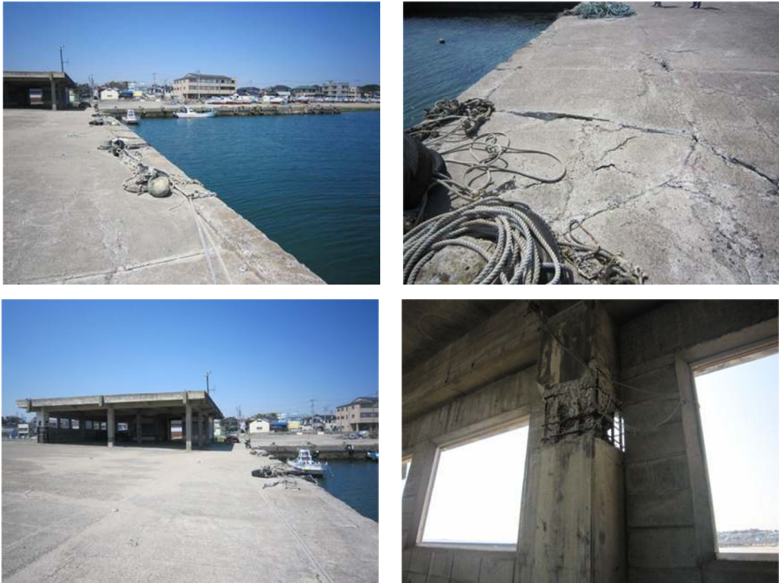
写真 2.1 平磯漁港の被災状況
