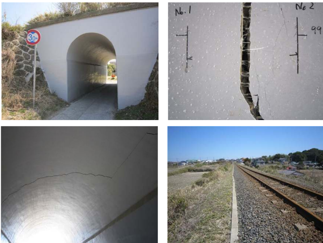
写真 1.4 平磯～磯崎区間トンネル内部の亀裂と鉄道盛土の沈下状況
