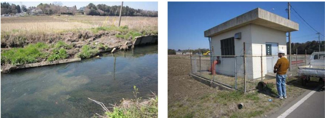
写真 1.3 大川護岸崩壊と揚水機場建物の傾斜
