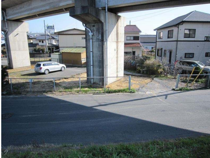
鉄道橋脚基礎部の沈下。
