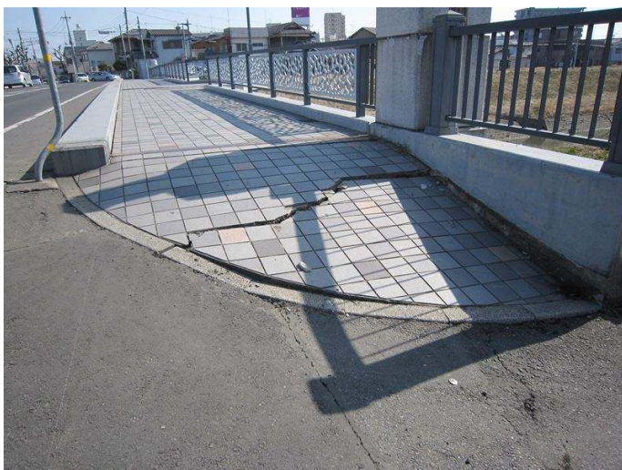
石垣橋における歩道部の亀裂
